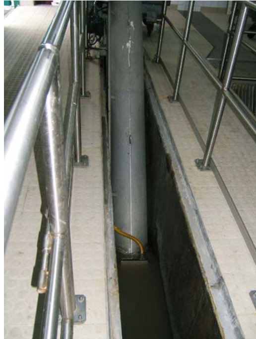
a - links: Vorklärung (Rechen)
