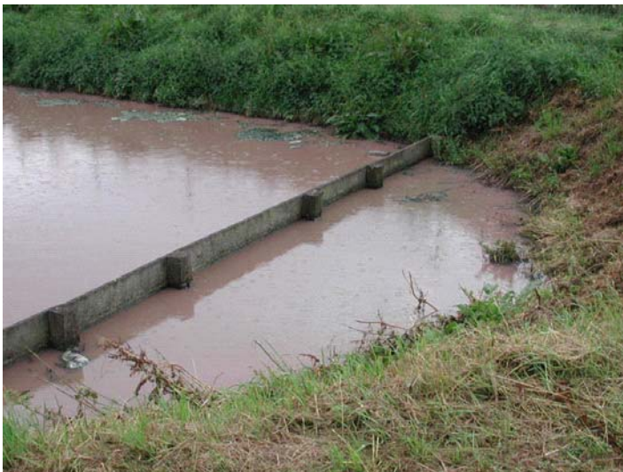
Bild 38: Ablauf des ersten Teiches der Anlage Barneberg, Schwimmschlamm Sperre, Rotfärbung durch Bakterien
