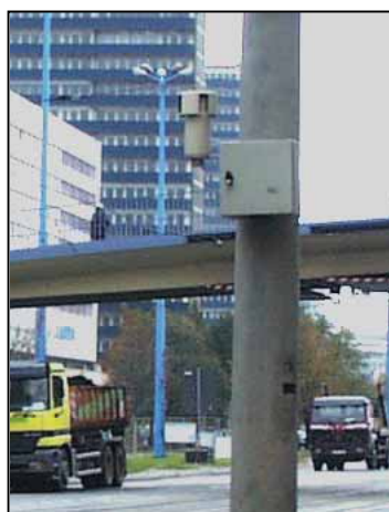
Abbildung 2.5.2: Sigma 2-Halterung für \text{NO}_2 -Passivsammler und NUPS für BTX- und Rußbestimmung an einem Lichtmast
